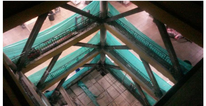
Arriostramiento metálico Centro Comercial Shangai
