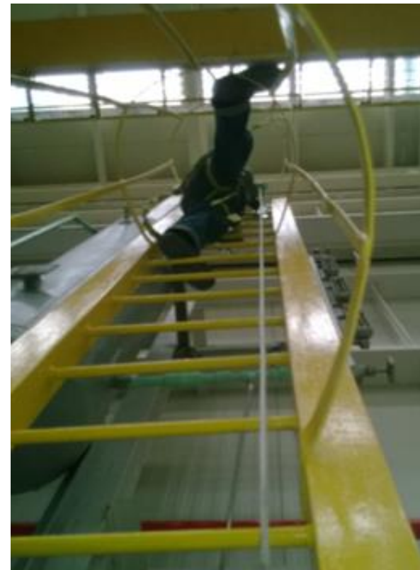
Línea de vida vertical en la Central Termoeléctrica de la Sierra - EPM
