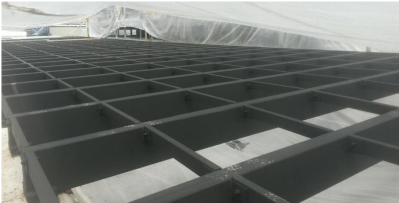
Cubierta metálica Distritos Térmicos - EPM
