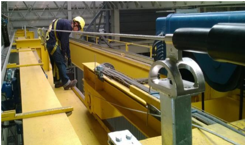
Línea de vida Horizontal interna en puente grúa de la Central Termoeléctrica de la Sierra de EPM
