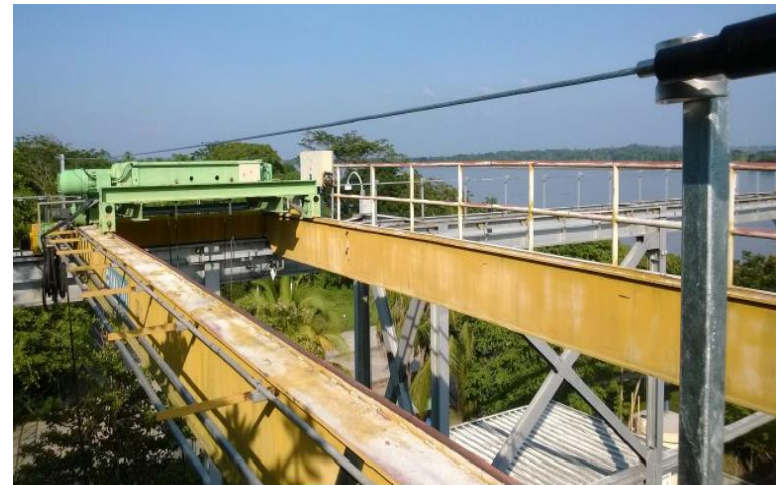
Línea de vida Horizontal externa en puente grúa de la Central Termoeléctrica de la Sierra - EPM
